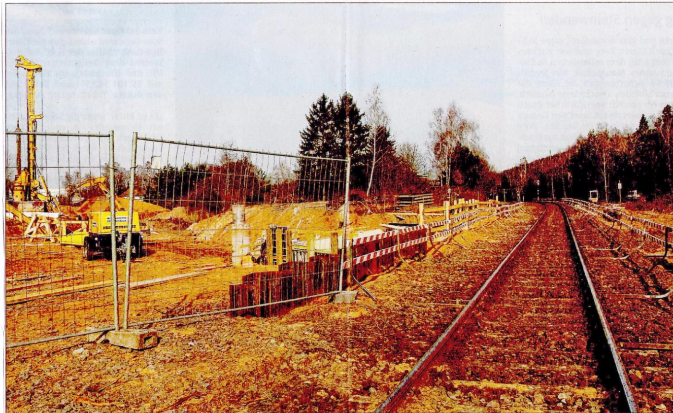
An allen Ecken der künftigen Umgehungsstraße Enkenbach-Alsenborn wird 2011 gearbeitet, hier ein Blick auf die Gleisanlagen am Bahnhof und die künftige Trasse der Umgehung (links). FOTO: VIEW
